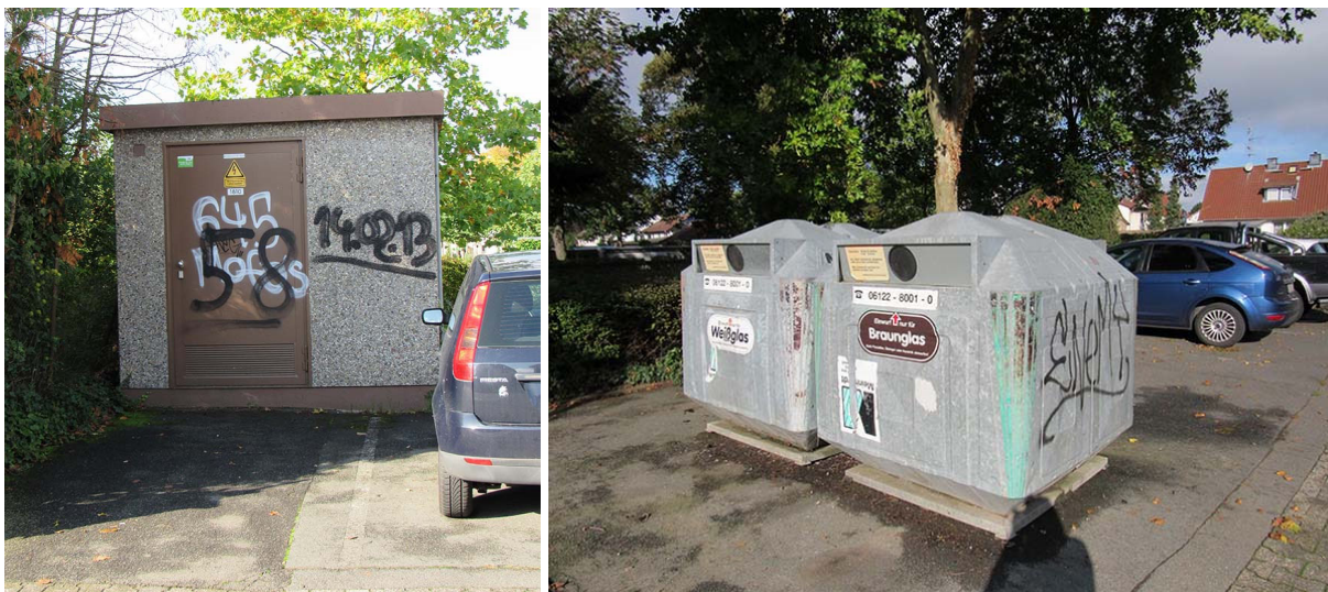
Abbildung 7: Trafostation am südlichen Plangebietsrand (links); Altglascontainer im Bereich der Stellplätze (rechts)
