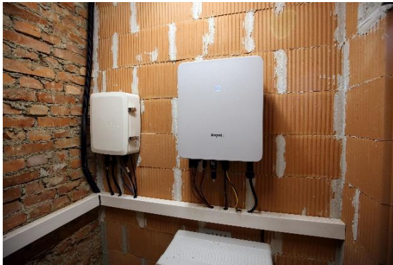
Photovoltaik-Anlage mit Wallbox (Enpal)
