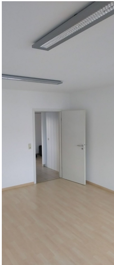
Büro 11 mit Beleuchtung
